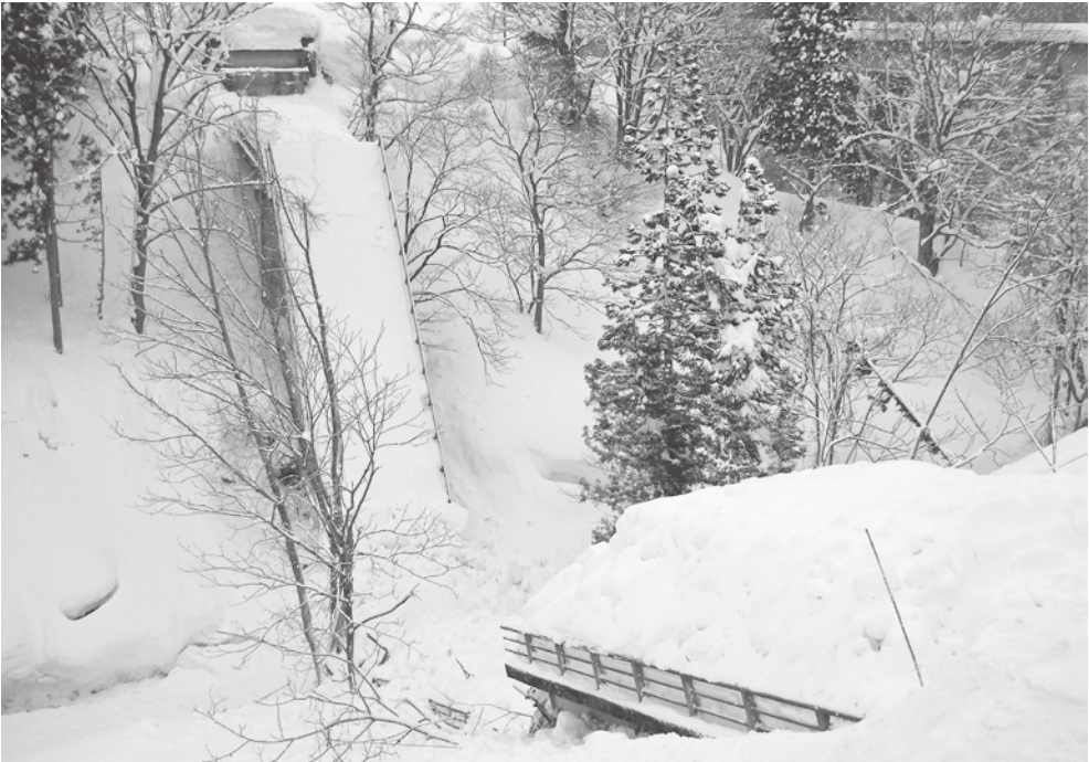
震災により橋脚が破損し、雪の重みで落下した中条橋
