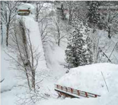
崩落した中条橋（平成24年）
