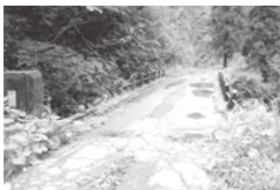
▲村道極野線：昭和34年に建設された 橋梁破損状況
