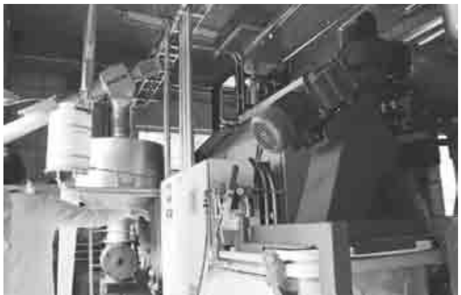
保科温泉設置の木質 バイオマスペレットボイラー▶
