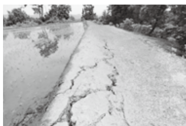
▲地震により被害を受けた水田
