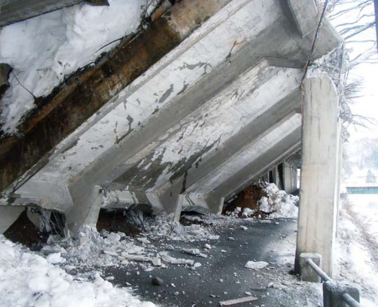
土砂崩落により倒壊した清水河原スノーシェッド（県道箕作飯山線）
