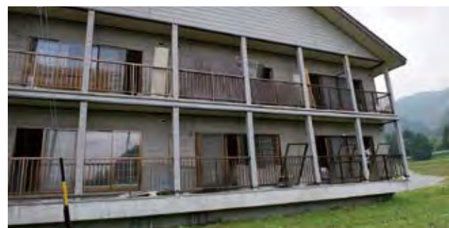
損壊した村営住宅【志久見】
