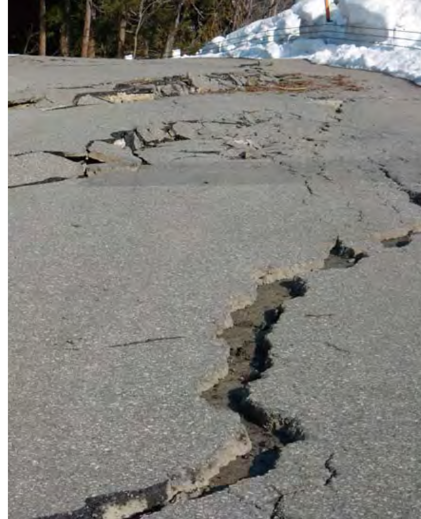
大きく路面が損壊した村道〔青倉〕
