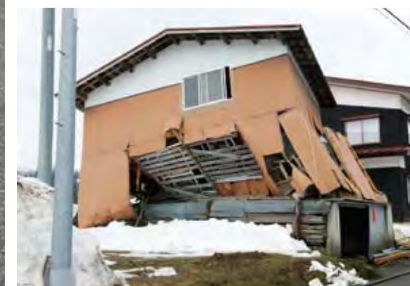
倒壊した建物〔青倉〕
