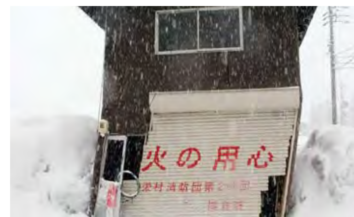
損壊した消防ポンプ小屋〔横倉〕
