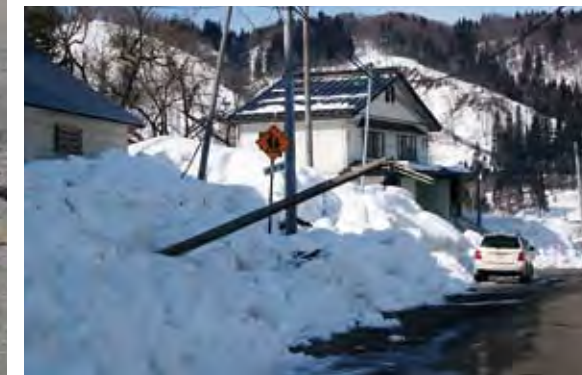
倒れて損壊した外灯〔横倉〕
