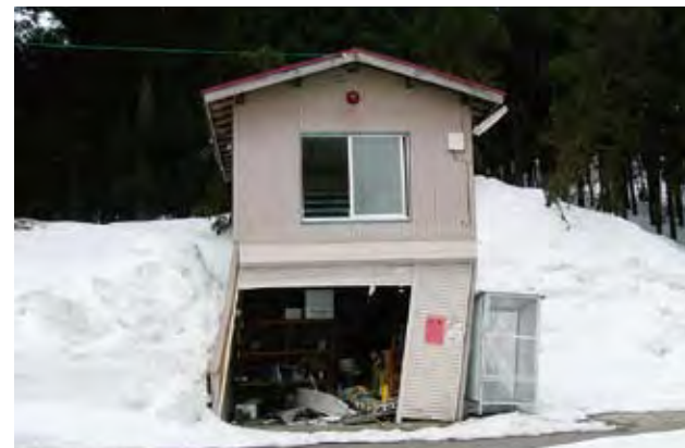
1階が傾き、損壊した消防ポンプ小屋 [野田沢]
