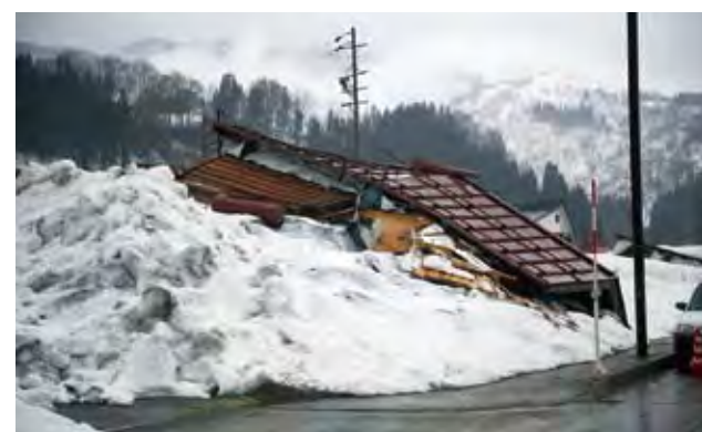
完全に倒壊した建物〔青倉〕
