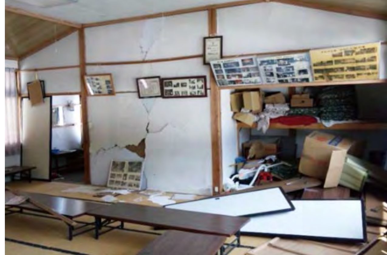
壁が崩れ落ち、物が散乱した公民館【原向】
