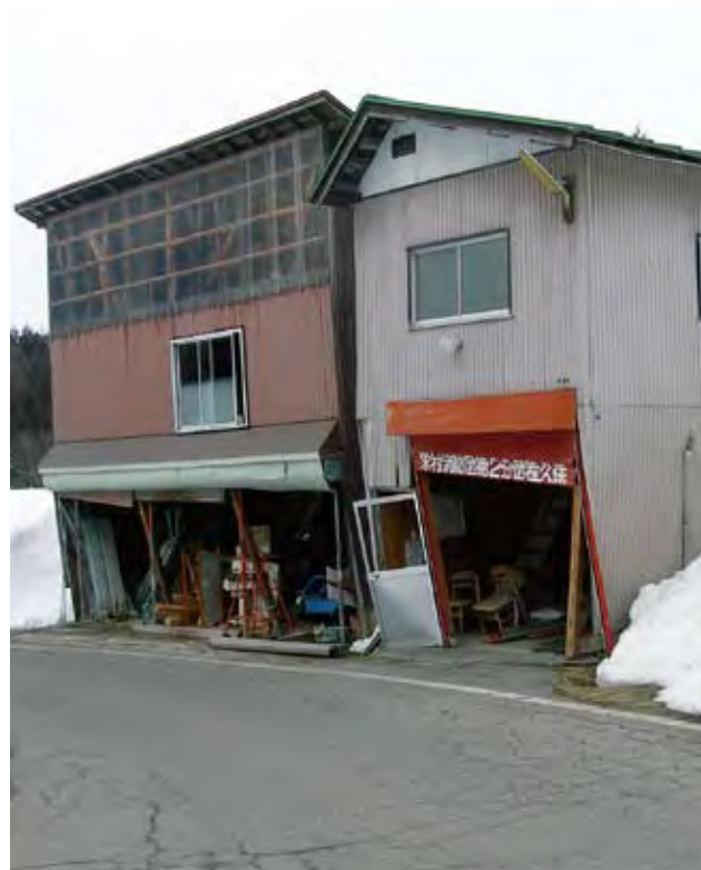
損壊した消防ポンプ小屋と作業所 [程久保]
