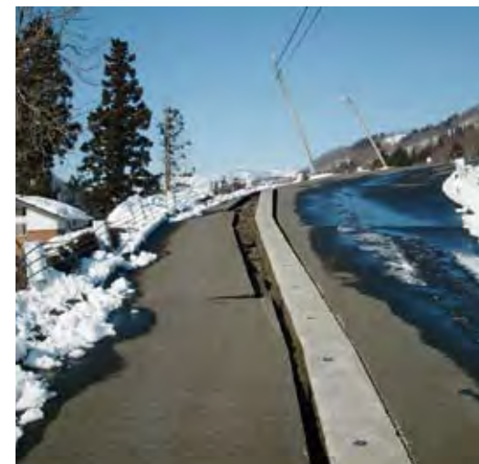
大きな亀裂が生じた村道 [平滝]
