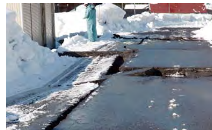
段差が生じた村道〔横倉〕
