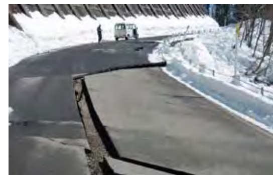
大きく損壊した村道【天代～原向】
