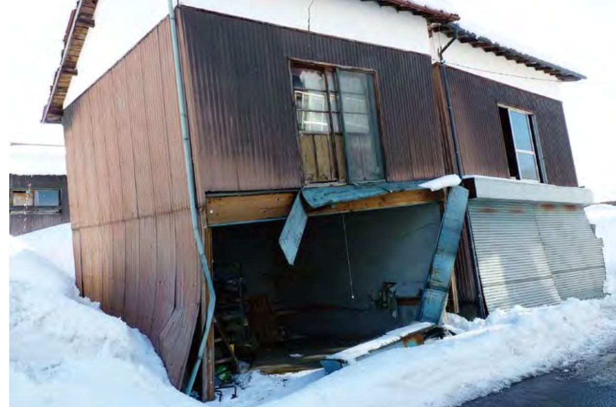
1階駐車スペースが傾き、損壊した建物 [小滝]
