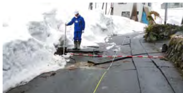
陥没した村道【雪坪】
