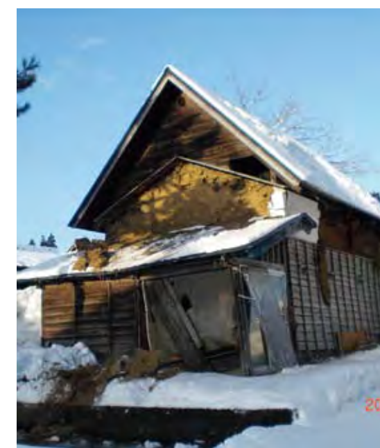
壁が剥がれ落ちた土蔵 [泉平]
