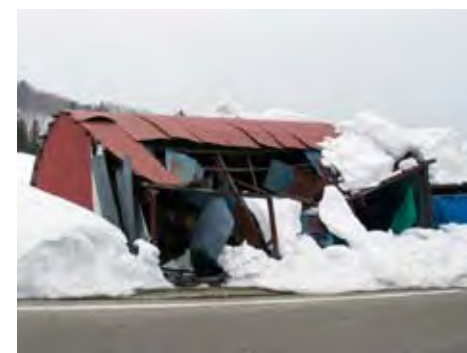
損壊した建物【切欠】
