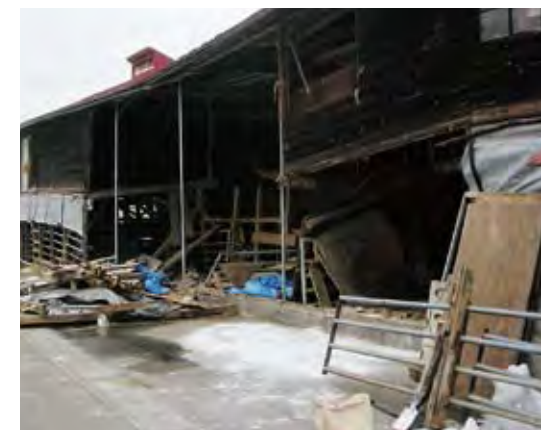
倒壊した牛舎 [小滝]
