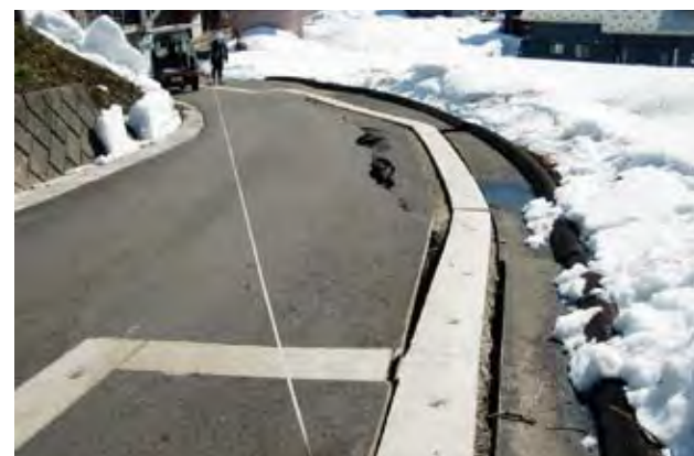
路面が陥没し、損壊した村道 [箕作]
