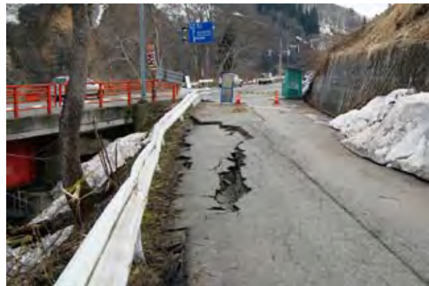
路面が陥没した村道 [森]
