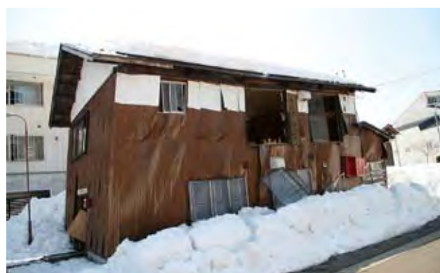
損壊した横倉桐下駄工房〔横倉〕
