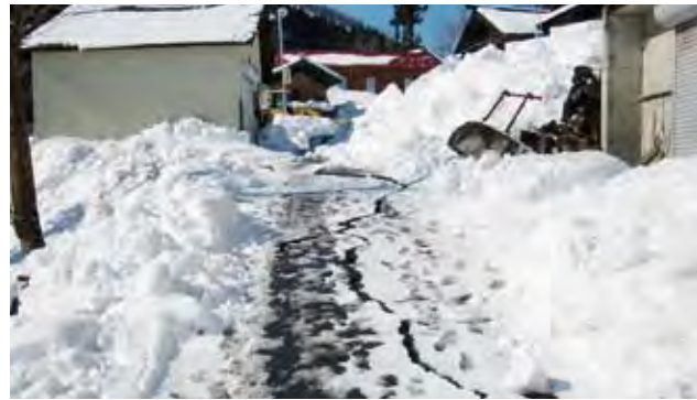
亀裂が生じた村道【坪野】
