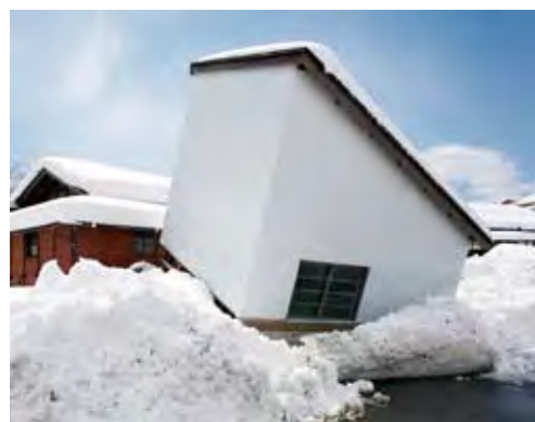
全体が傾き損壊した建物〔青倉〕
