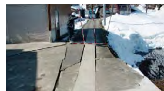
亀裂が生じた村道 [月岡]
