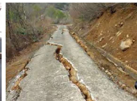
亀裂が生じ、損壊した農道〔青倉・西山田〕
