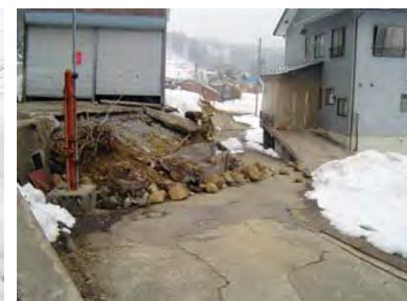
崩落した家屋の石垣〔横倉〕
