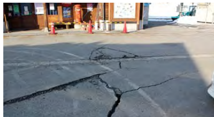
路面に亀裂が生じた森宮野原駅前 [森]
