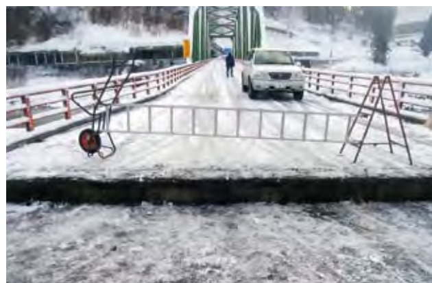
段差が生じた百合居橋
