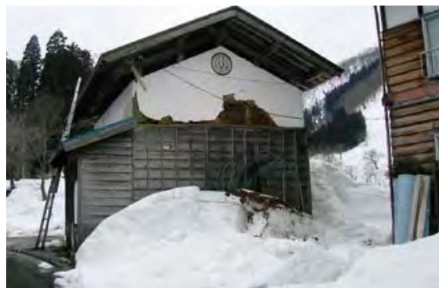
壁が剥がれ落ちた土蔵【極野】
