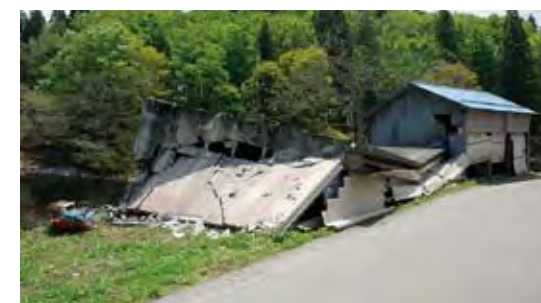
完全に倒壊した共同車庫 [泉平]
