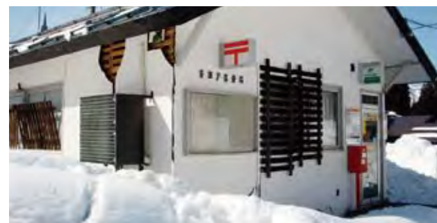
外壁等が損壊した郵便局 [野田沢]
