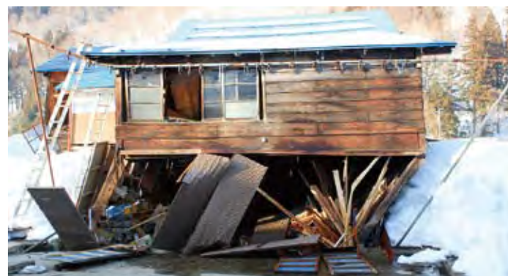
1階部分が大きく損壊した建物 [森]
