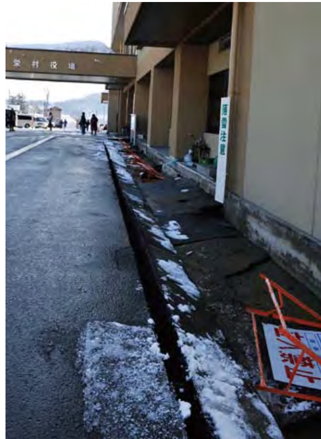
敷地や設備に被害が生じた役場庁舎 [森]
