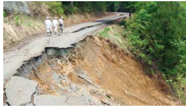
大きく亀裂が生じ、崩落した村道【極野～五宝木】
