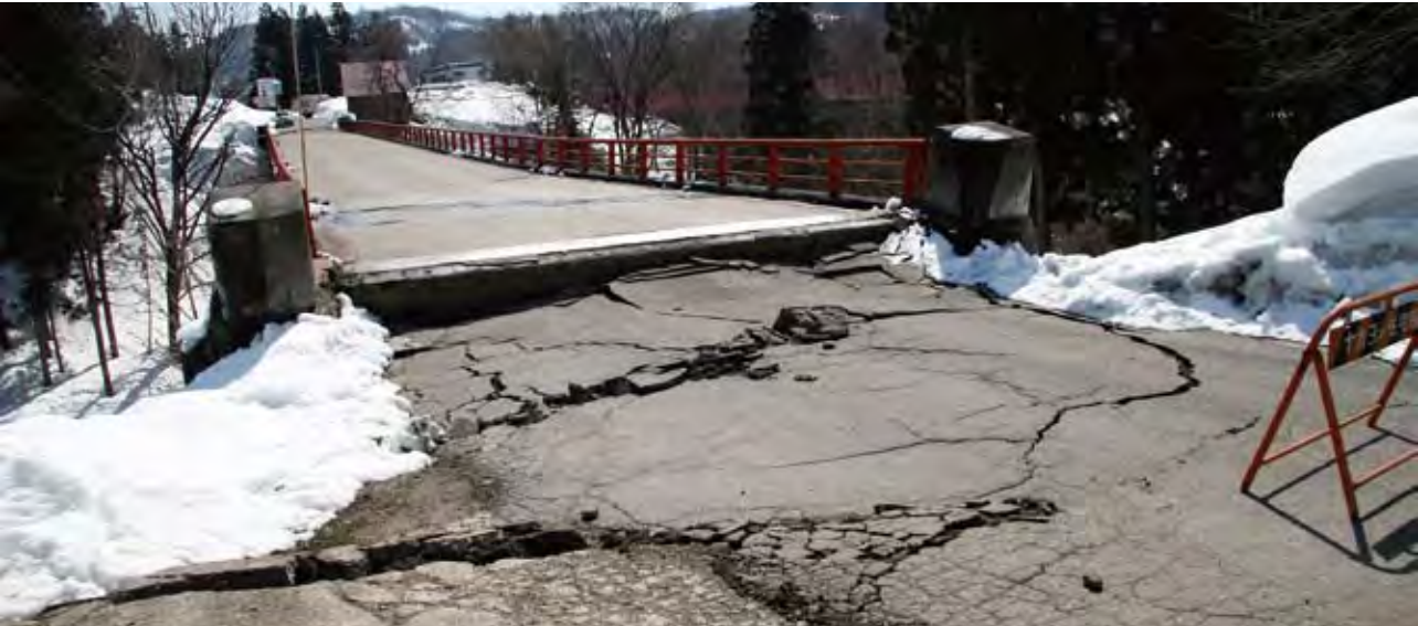
橋脚等が破損した中条橋（平成23年3月）
