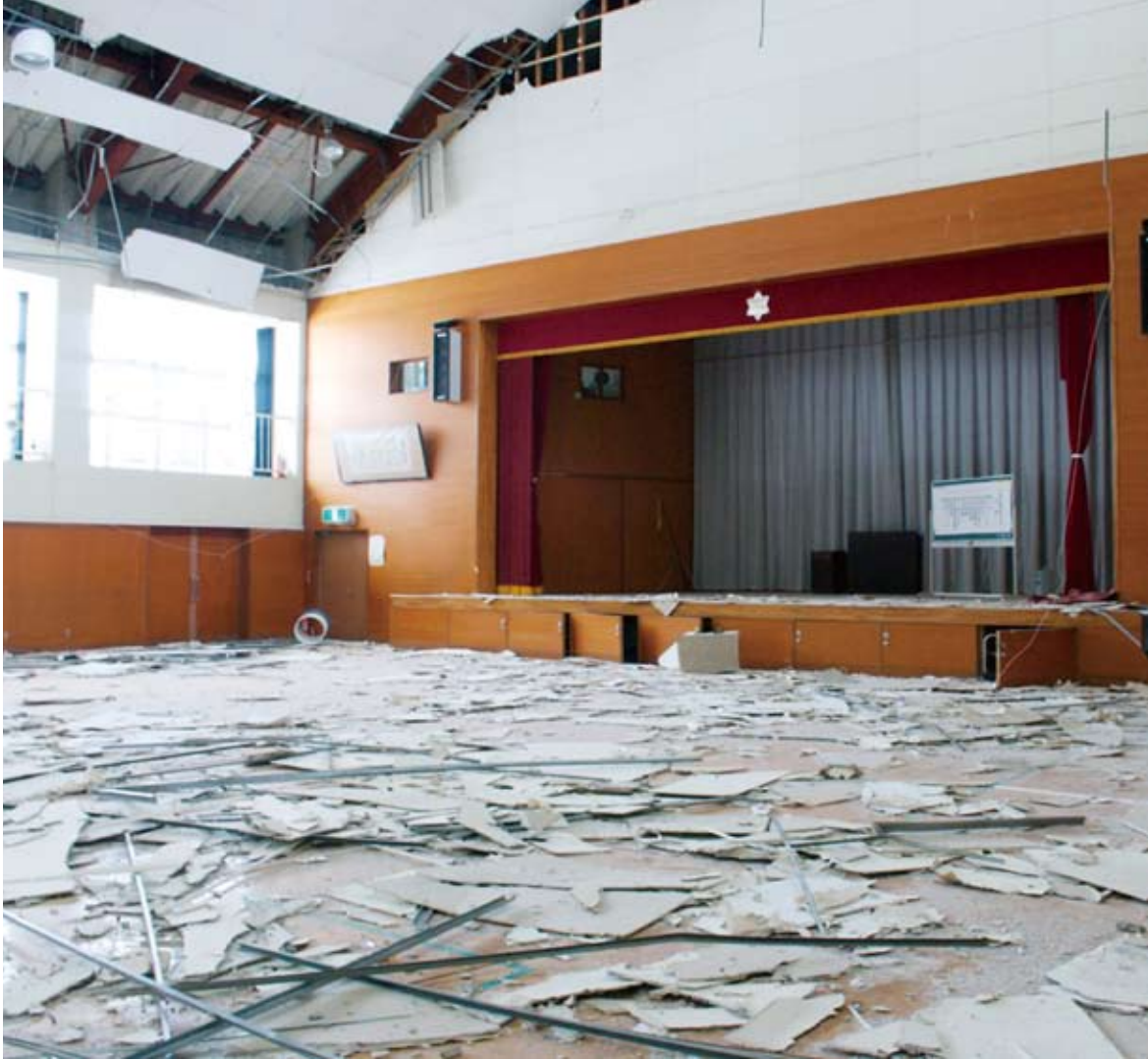
天井板等が崩落した体育館（旧東部小学校）
