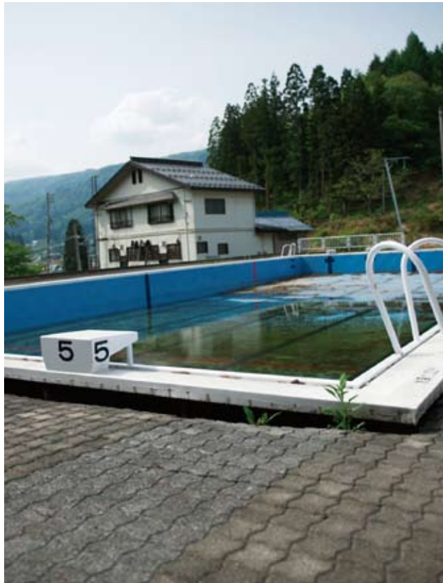
全体が歪み、配管等が損傷したプール（栄小学校）
