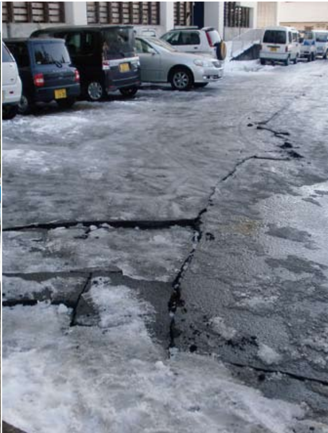
敷地のアスファルトにも大きな亀裂が生じた（栄小学校）
