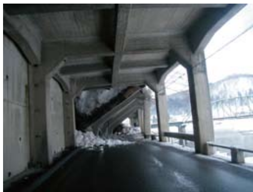
被災状況（平成23年3月）
