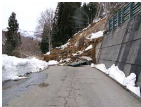
被災状況（平成23年3月）
