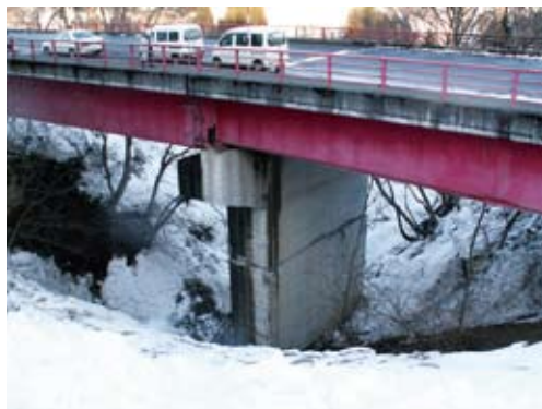
被災状況（平成23年3月）
