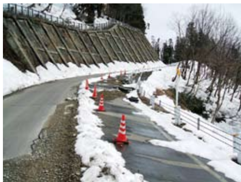
被災状況（平成23年3月）
