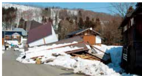
長野県北部地震 被災家屋
