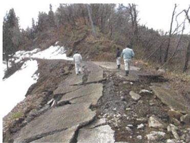
【H23 年の震災により崩壊した道路】
